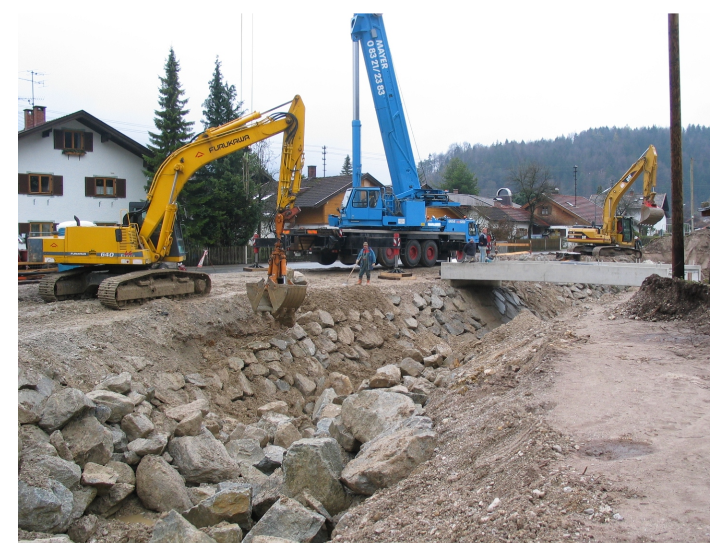
Dadurch konnte in dem Abschnitt die Tieferlegung der Sohle und der Ausbau vollständig im Trockenen erfolgen, was spürbar am Baufortschritt zu bemerken war.
