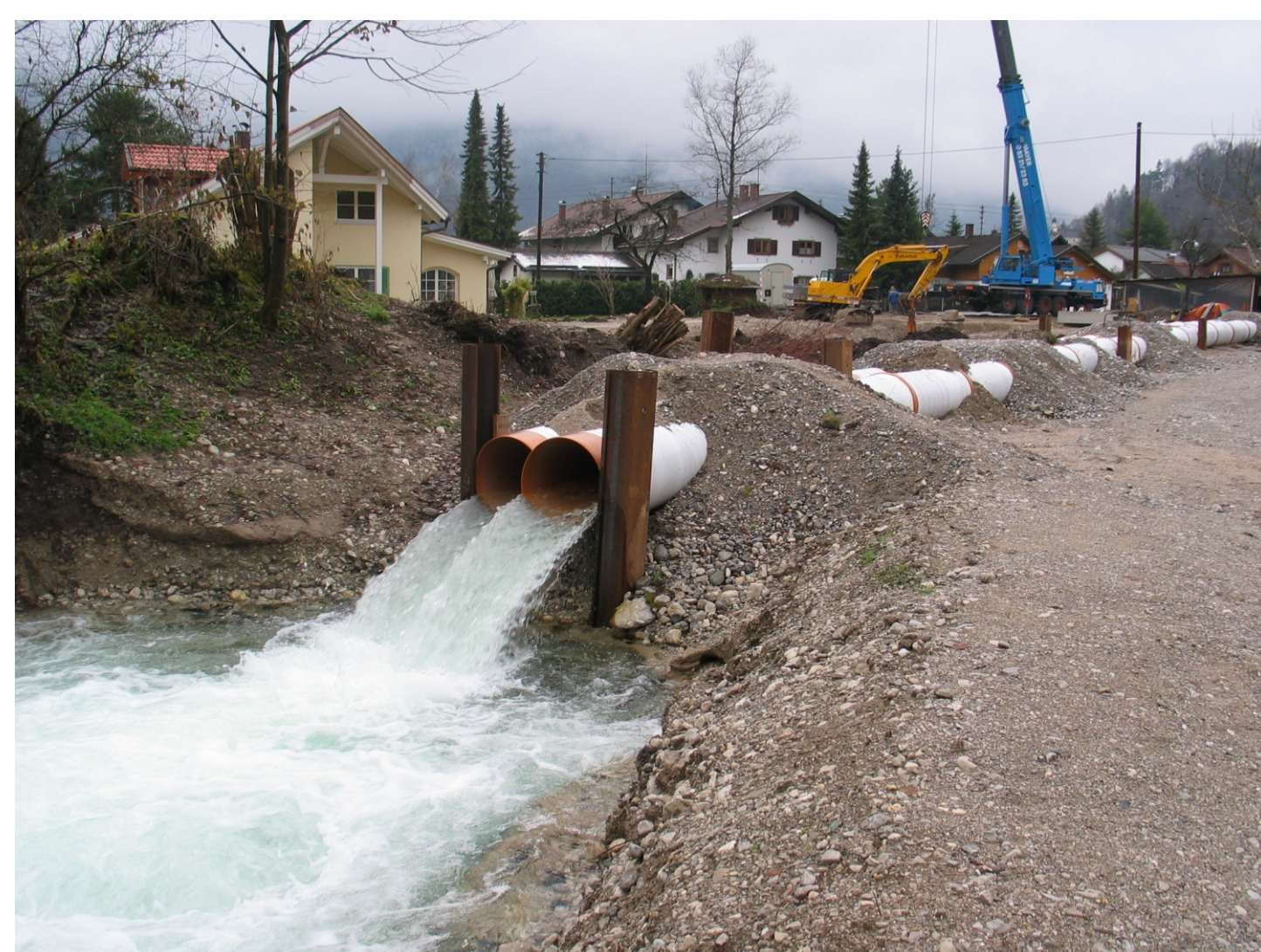
Von der Mühlbacheinleitung Fischer oberhalb der Gärtnerei Fink bis unterhalb der Stadtwerke wurde der Gießenbach während der Baumaßnahmen komplett umgeleitet, streckenweise in Rohren ...
