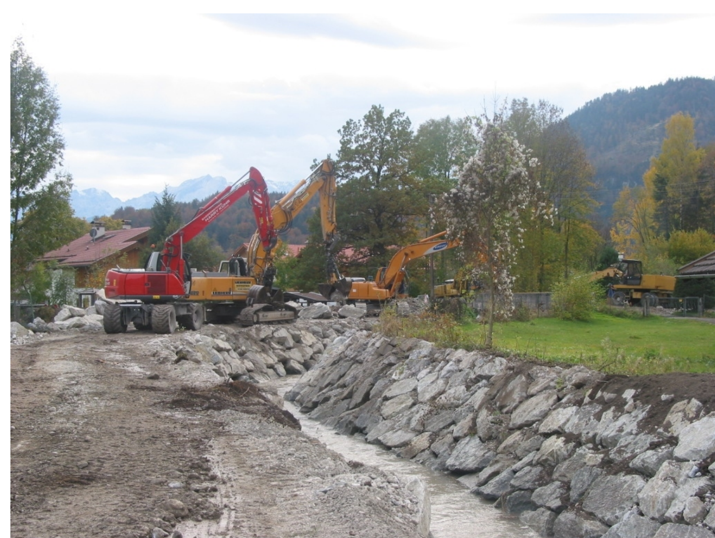
Unter Ausnutzung von Schönwetterperioden wurde der Ausbau mit mehreren Baggern gleichzeitig vorangetrieben.
