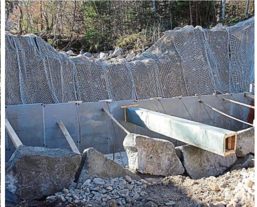
Der Auffangraum wird durch eine so genannte Konsolidierungssperre begrenzt. Schwerer Granit wird zur Befestigung verwendet. FOTOS: FN
